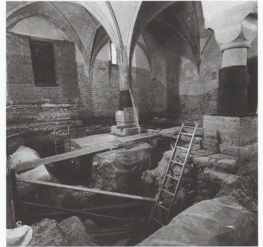
Abb. 36: Blick in die Ulrichskapelle, 20.9.1999 Erkennbar ist der Grabungsfortschritt und der schlechte Zustand der Raumschale
